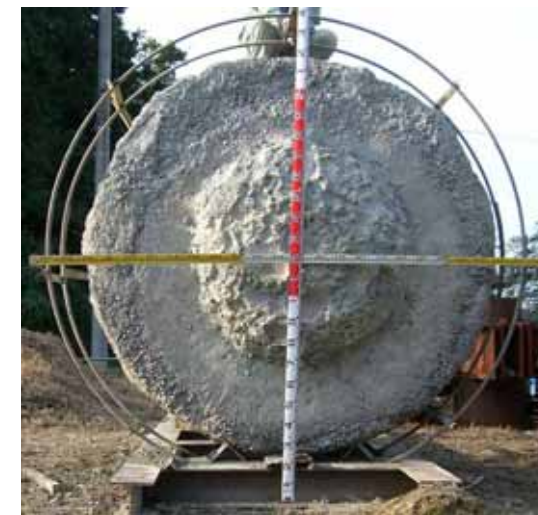
2100 拡底部写真 (杭先端地盤が玉石混り砂礫層に もかかわらず真円に近い拡底部)
